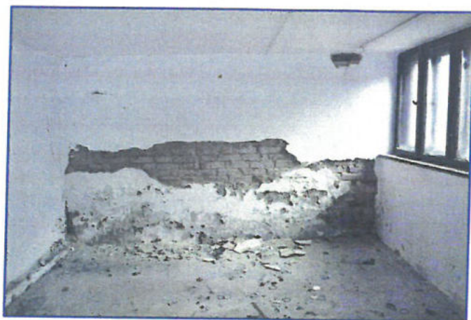
BUD. ADMINISTRACYJNY - PIWNICE
