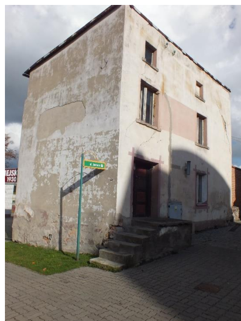
Stan przed konserwacją
